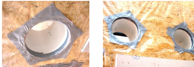
Рис. 7.2 Герметизация стыков гильзы с наружными и внутренними поверхностями стеновой панели, для предотвращения проникновения атмосферной влаги и водяных паров внутрь стеновой конструкции
