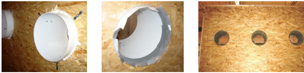
Рис. 7.1 Вариант крепления гильз для прохода коммуникаций вентиляционных систем и кондиционеров в наружных стенах здания
